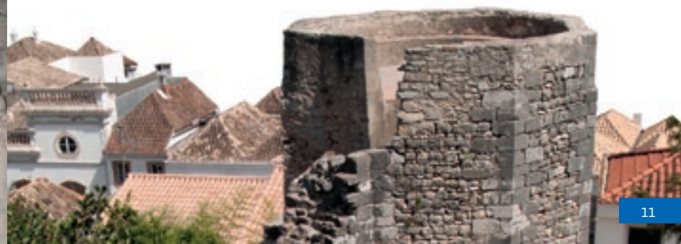
Torre octogonal do Castelo de Tavira e alguns telhados de quatro águas (em baixo)
